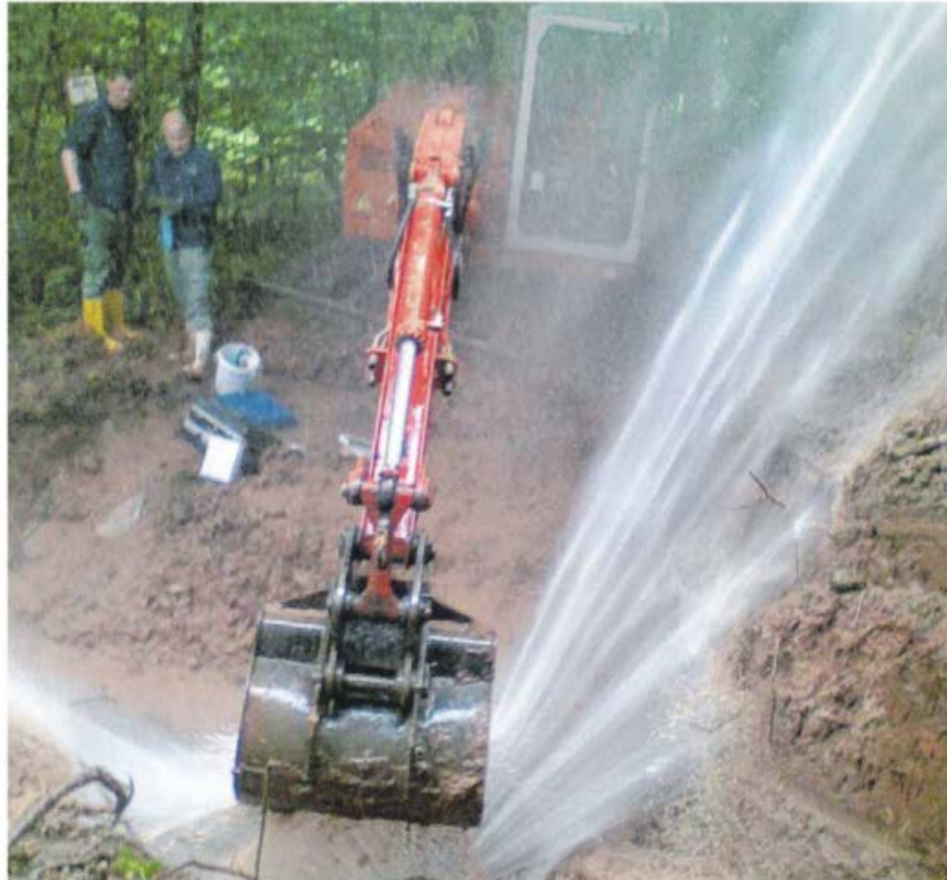
Dieser Rohrbruch bei Schlechtenrain konnte nur mit einem Bagger angefahren werden.
